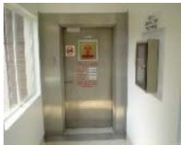
インターロック制御された高気密扉
