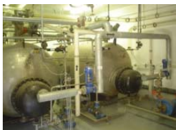
高圧蒸気滅菌処理設備
