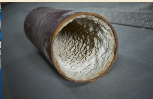
これが問題の湯の華。パイプのなかにびっしり！
